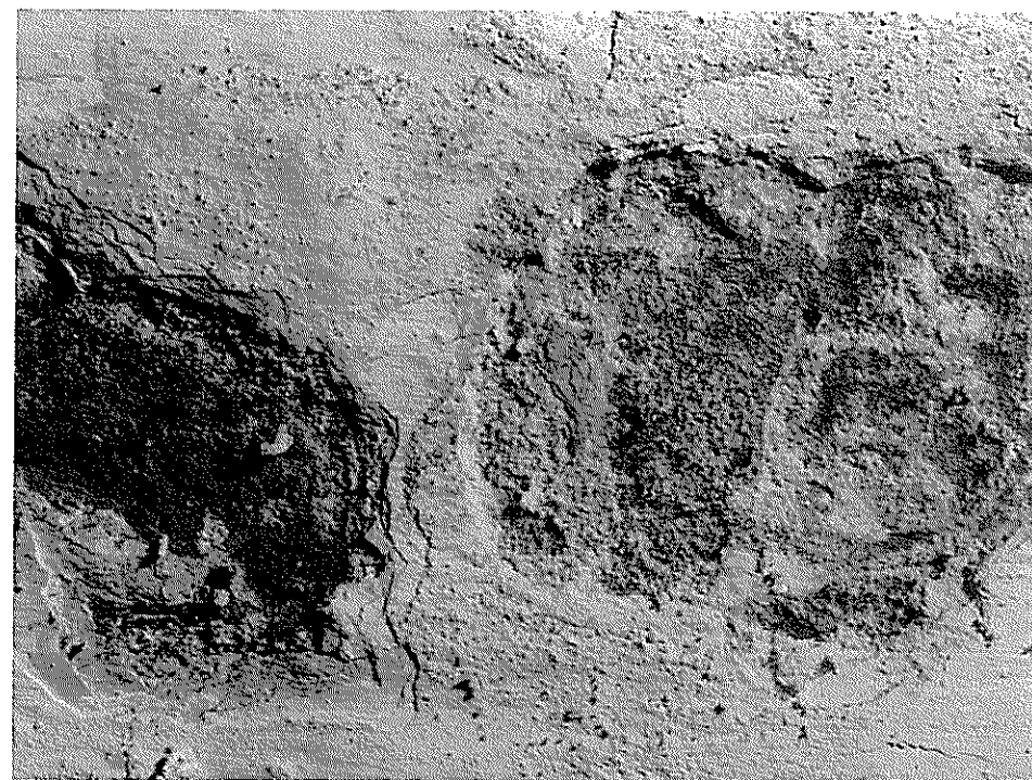
Skader på murværk efter saltudsvedninger.
