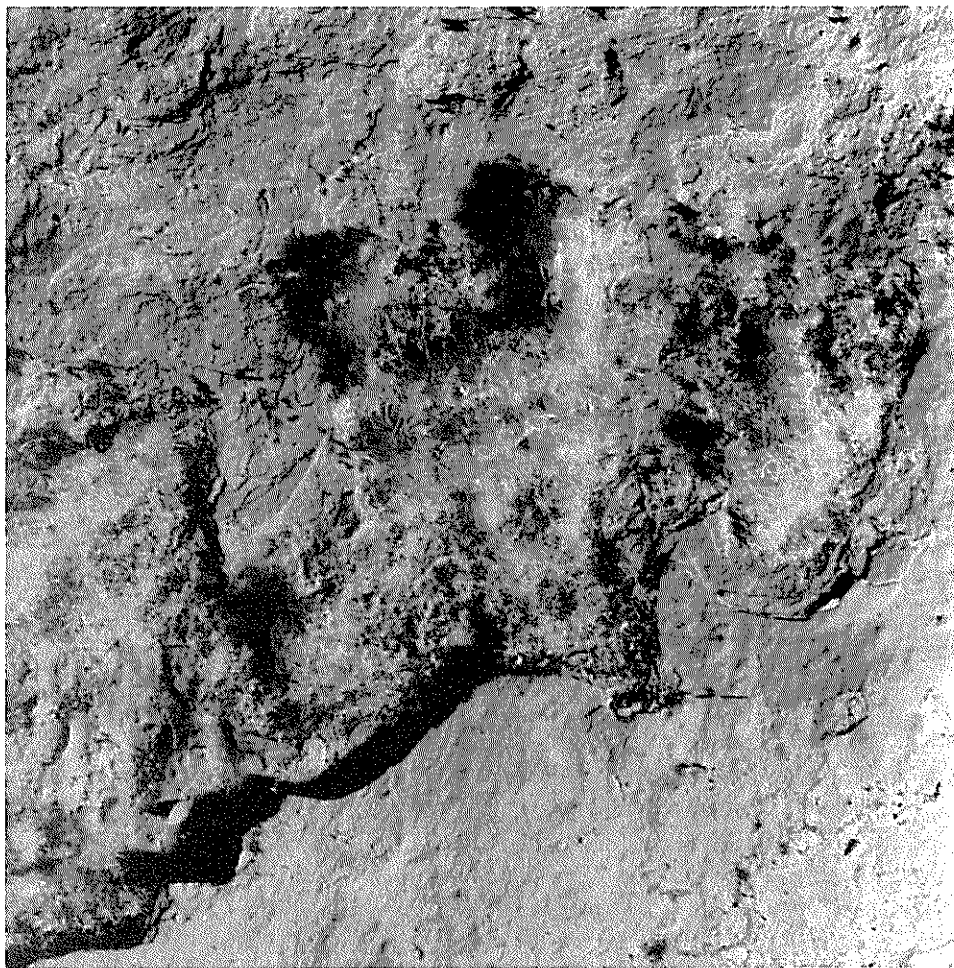
Saltudsvedninger på murværk. Saltene er udkrystaliseret under kalklaget, som er ødelagt. På murens overflade er efterladt en fnugget udblomstring.
