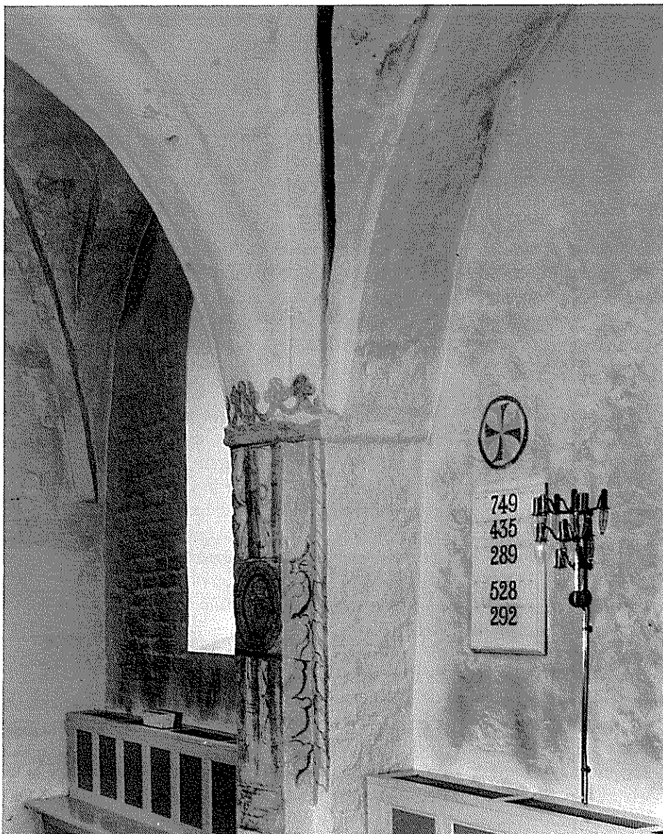
Varmeskader på murværk.
