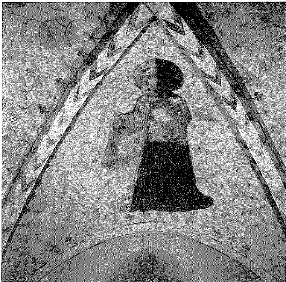
Renseprøve foretaget i forbindelse med genrestaurering af kalkmaleri. De mørke partier viser graden af tilsmudsning i løbet af kun tolv år efter forrige restaurering ved kontinuert opvarmet kirke.
